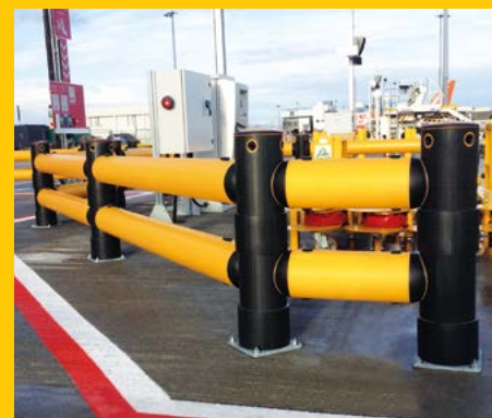
Zábrana Atlas Double Traffic Barrier chrání stožár osvětlení letištní dráhy.
