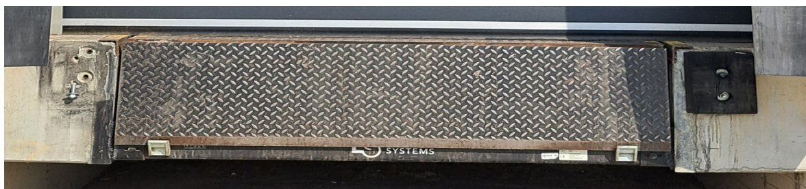
Rampa č. 2 gumový doraz vytržen z kotev
