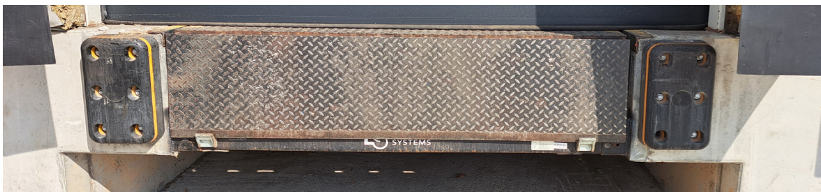
Rampa č. 3 DockBuffer v perfektním stavu bez známek poškození
