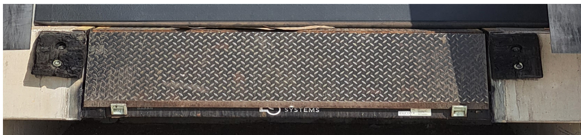
Rampa č. 1 gumový doraz těžce poškozen
